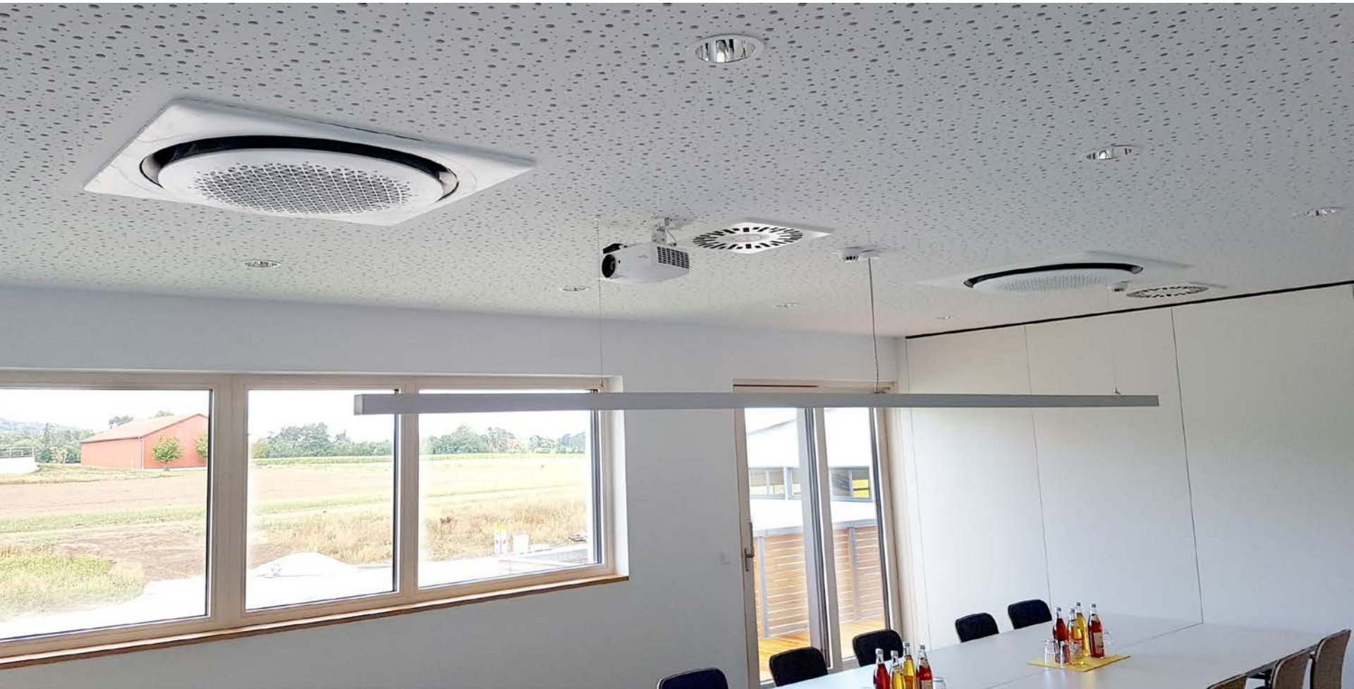
Foto der installierten Wind-Free™ 360° Round Airflow Deckenkassetten
