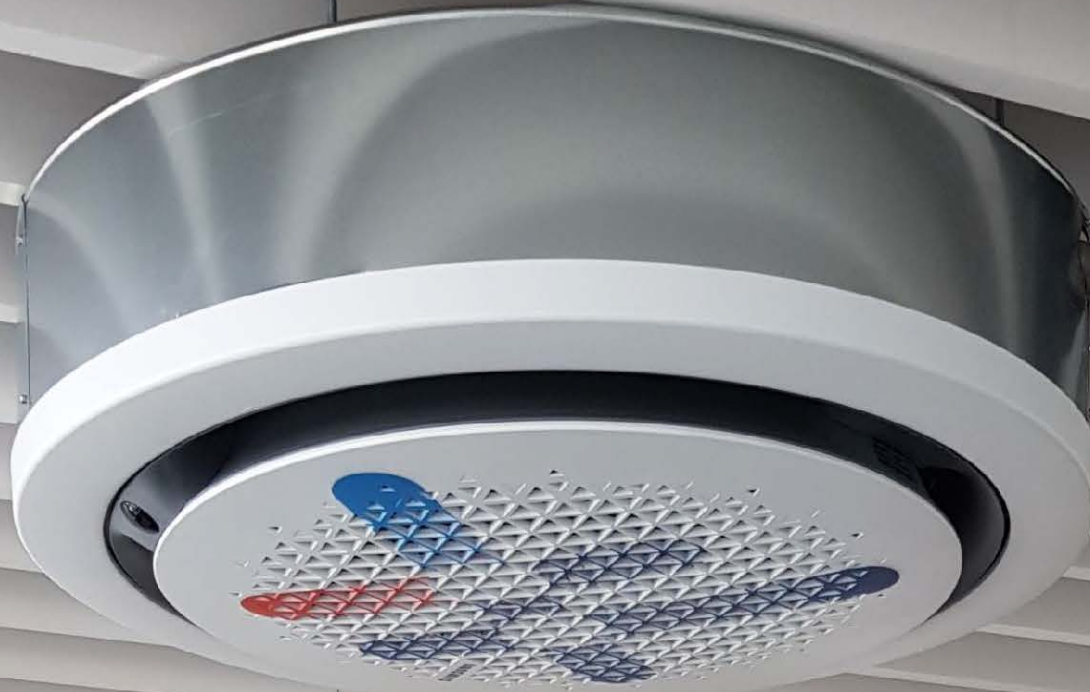
Foto der installierten Wind-Free™ 360° Round Airflow Deckenkassetten mit Vollverkleidung und rundem Ausblaspaneel
